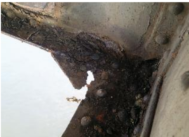
Koroze dolních pásů v připojích chodníkových konzol.
