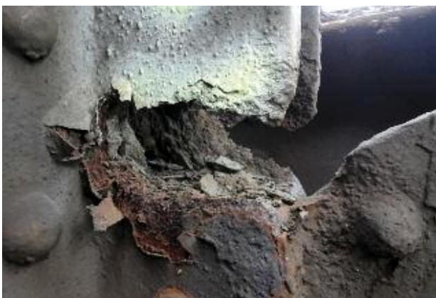
Silná štěrbinová koroze členěných prutů svíslíc v připojení na styčnickový plech dolního pásu (odkorodování celé příruby úhelníku).
