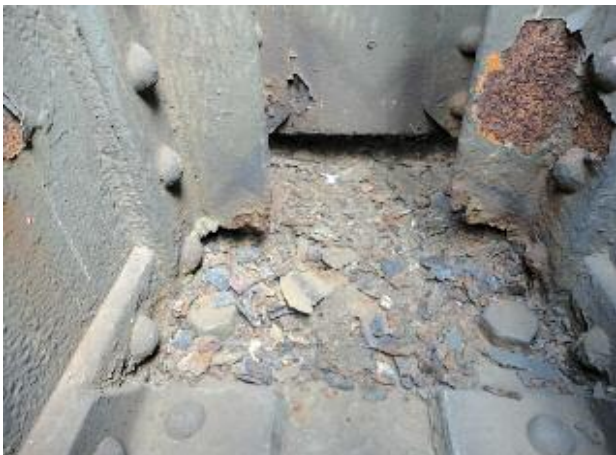
Koroze nadložiskových oblastí – portálová svíslice.
