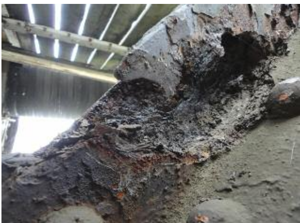
Silná štěrbinová koroze členěných prutů diagonál v připojení na dolní pás (odkorodování celé příruby úhelníku).
