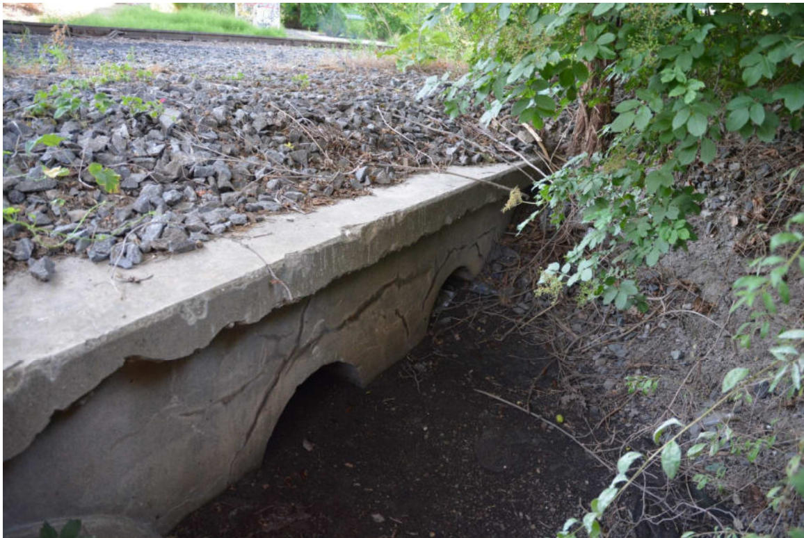
Obrázek 5 Propustek v km 1,572 pod kolejí 901. žst. Praha-Libeň. Nosnou konstrukcí tvoří dvě betonové trouby, v současné době zpola zanesené zeminou. Propustek bude zrušen a nahrazen novým v jiné poloze
