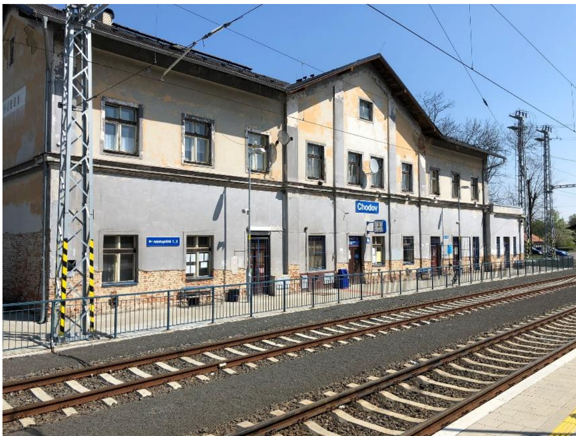
Pohled na historickou budovu, v zadní části přízemní partie, která je v havarijním stavu.
