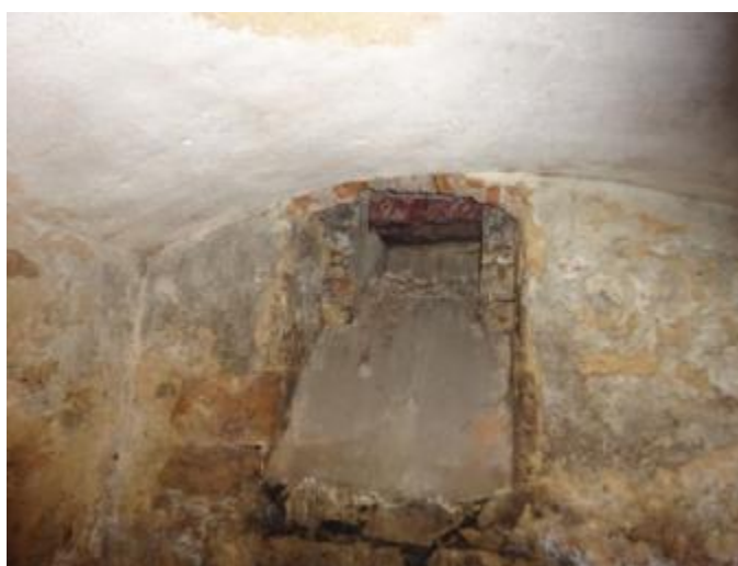
Zaslepený větrací otvor
