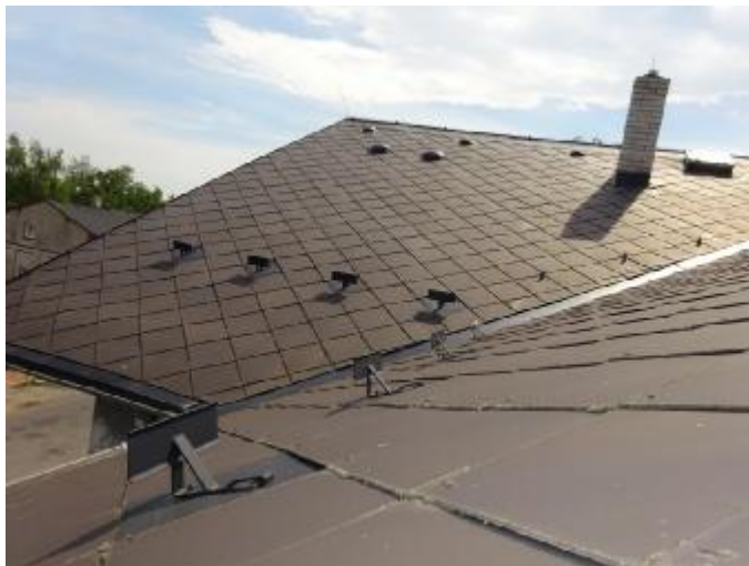
Střešní krytina, lokální výskyt lišejníku
