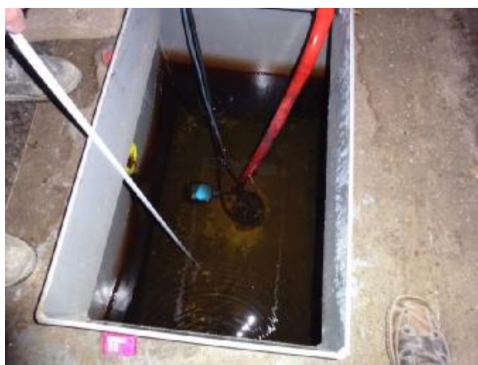
Jímka s čerpadlem
