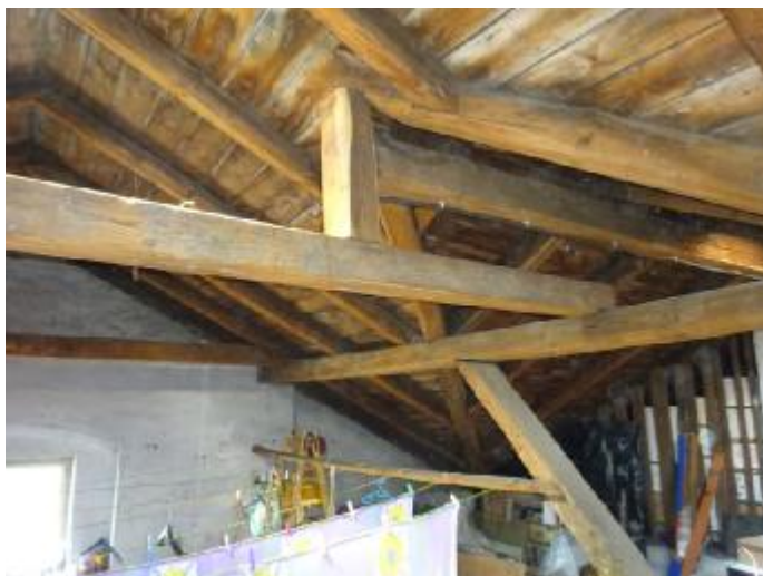
Krov střední části, průhyb vaznice
