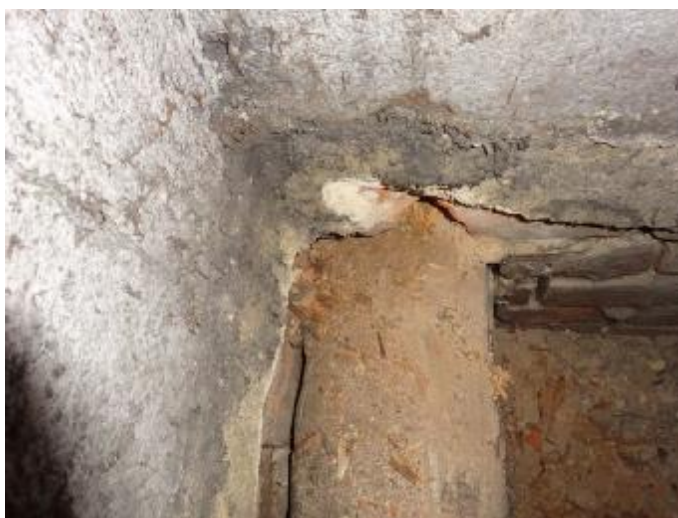
Půda, sonda V1, zhlaví trámu destruované dřevomorkou domácí
