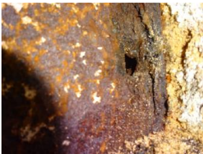
Totální koroze stojiny nosníku v sondě V8
