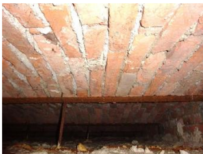
Strop nad 1.NP, sonda V7, koroze nosníků
