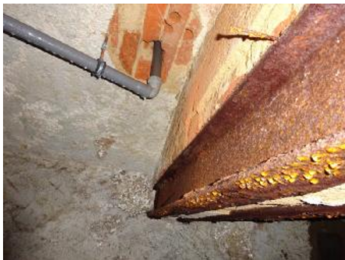
Koroze nosníků překladu v sondě V9, vysrážená vodní pára na spodní přírubě
