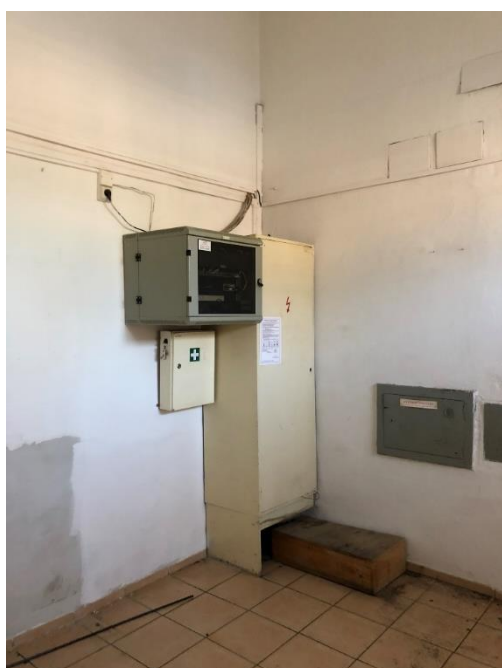
Pohled na jedinou technologii – zařízení Technické ústředny dopravní cesty, tato by se přemístila do sousedního technologického objektu.
