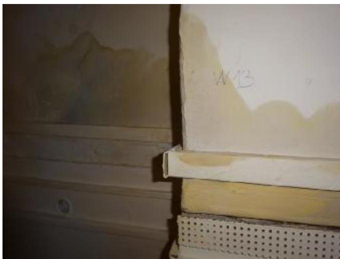
Projevy vlhkosti v přízemí
